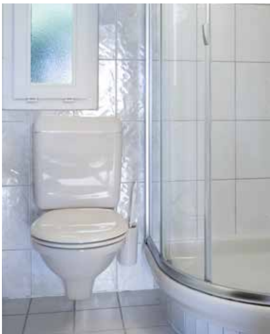
VORHER Einbausituation mit Aufputzspülkasten
